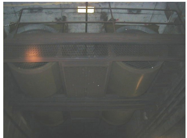
一对隧道喷气式排风扇
